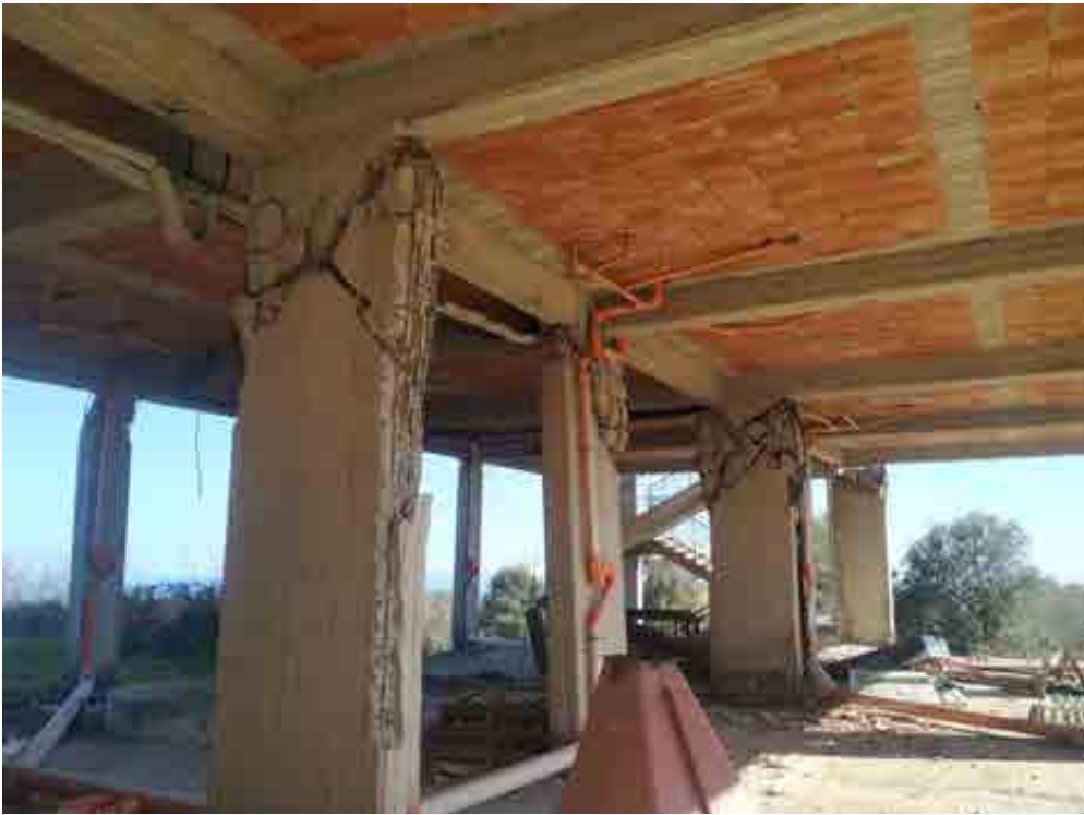
Fig. 3 Grave danneggiamento di pilastri in cemento armato, in un fabbricato realizzato sopra la faglia di Fiandaca
