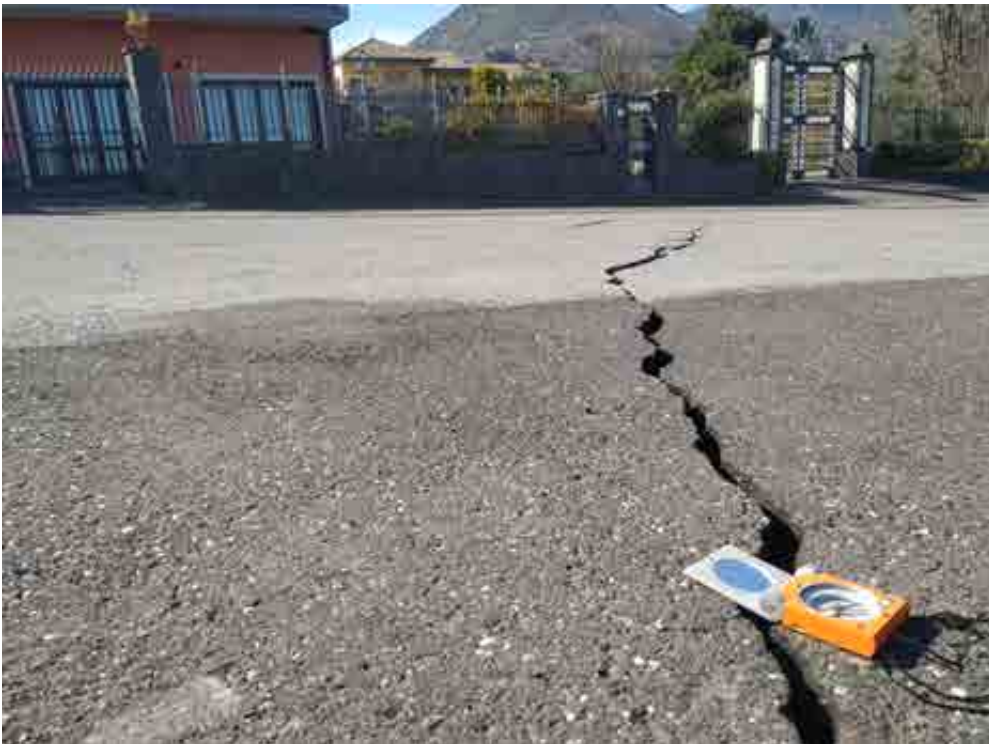
Fig, 2 Fratture tagliano il piano stradale alla periferia ovest di Fleri
